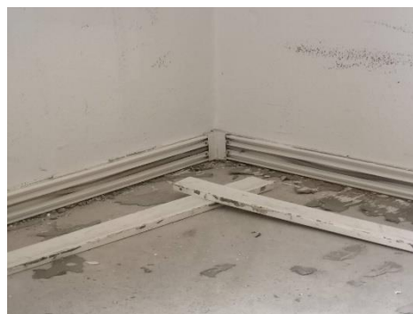
Plinthes non jointives et goulottes électriques
