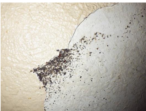
Dévoilées derrière un enduit décollé du mur
